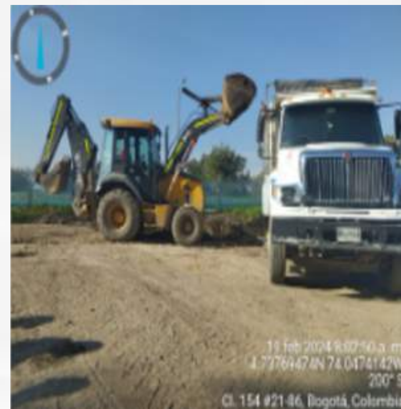
*Cobertura superior del transporte
