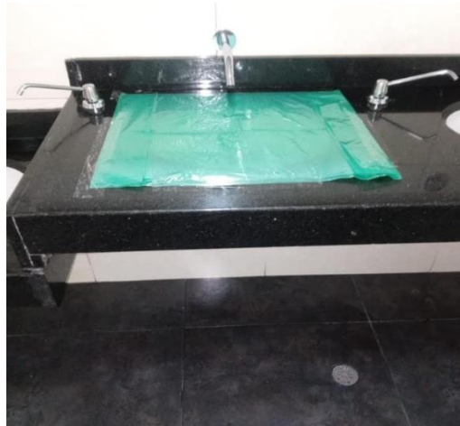
16/02/2024 Se destapó lavamanos de reducción
