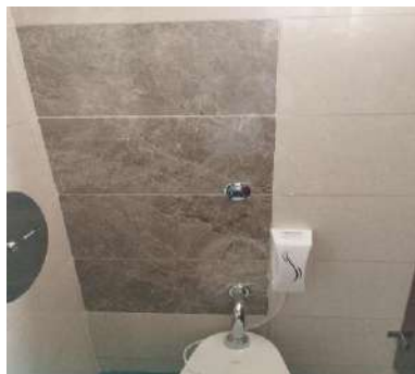
Imagen 23. Arreglo escape baño Fuente IDIGER
