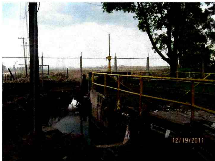
Foto 38. Compuerta antireflujo estación elevadora Fontibón, tomada el 19 de diciembre 2011
