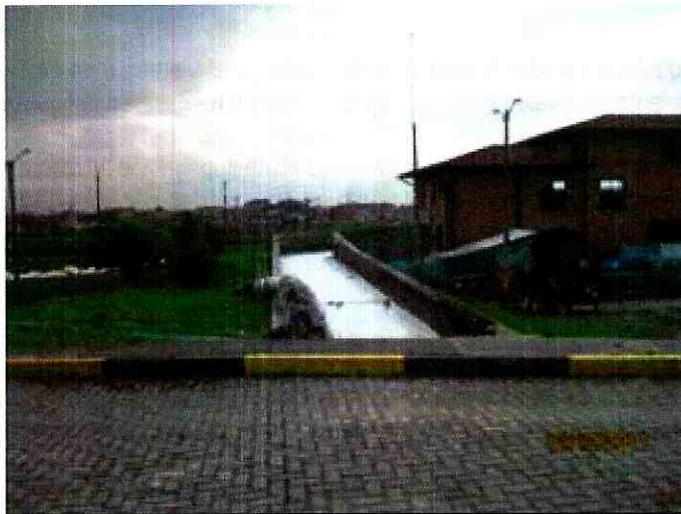
Foto 33. Descarga de bombes adicionales al canal de la estación elevadora Gibraltar, vista hacia el río Bogotá.
