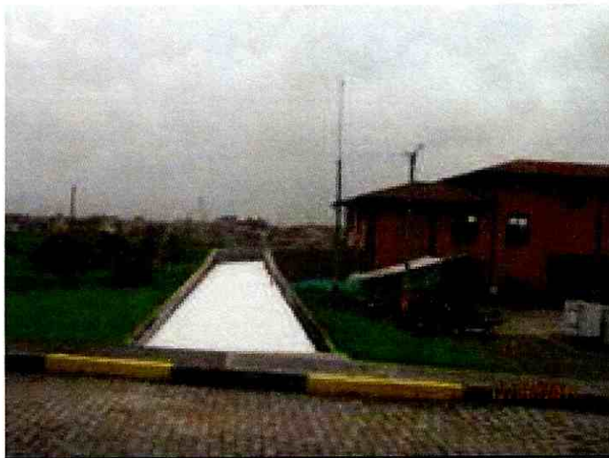
Foto 24. Espuma característica de agua residual en el canal de descarga de la estación elevadora Gibraltar
