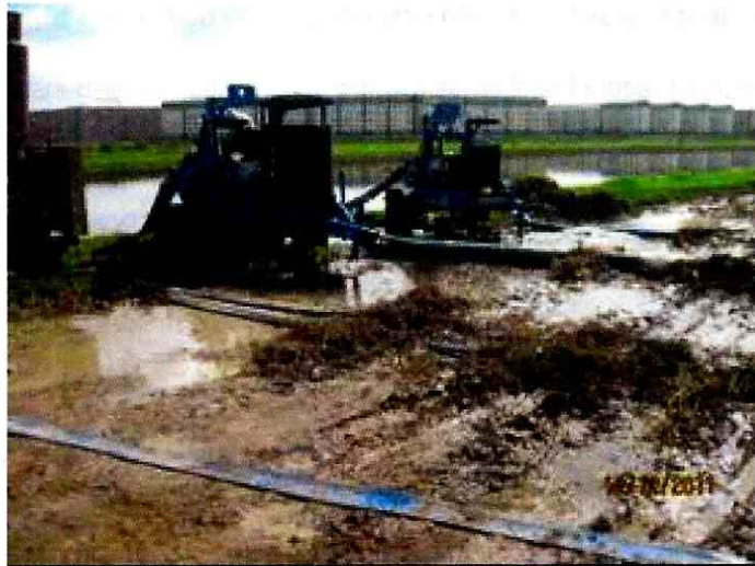
Foto 34. Bombeo desde el Canal Cundinamarca hacia el predio el Corso
