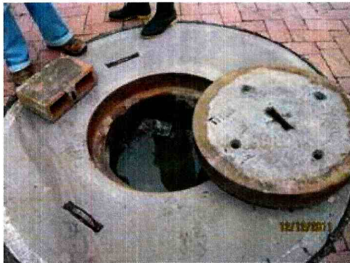
Foto 44. Reducción de nivel de agua en alcantarillas y parqueadero del conjunto residencial Reservado No 1 a partir del inicio del bombeo en el Tambre
