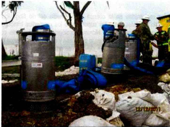
Foto 45. Bombas sumergibles instaladas por el FOPAE en el sitio del Tambre
