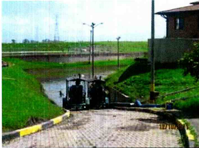
Foto 32. Bombeo adicional desde la estación elevadora Gibraltar, vista desde el canal Cundinamarca.
