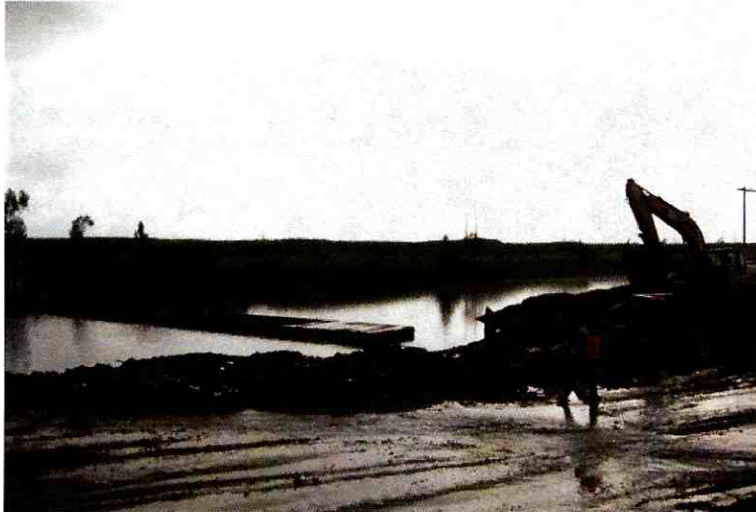
Foto 5. Construcción de la cámara norte del box coulvert que atraviesa el canal Cundinamarca.
