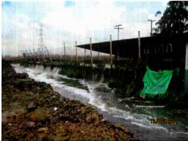
Foto 21. Inundación de la estación elevadora Fontibón y vertimiento al canal Cundinamarca a través del cerramiento
