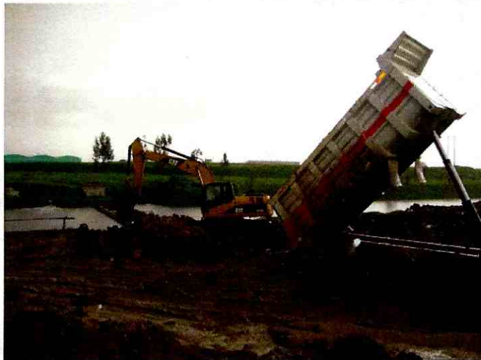
Foto 6. Construcción de la cámara norte del box coulvert que atraviesa el canal Cundinamarca.
