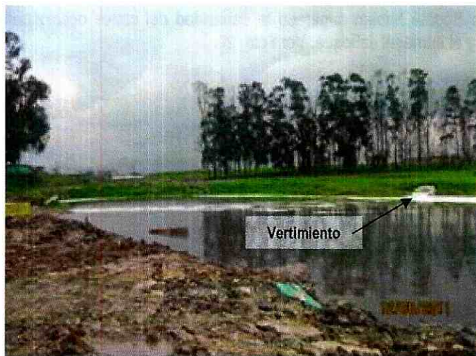
Foto 22. Vertimiento de aguas residuales desde el interceptor Villa Alsacia al Canal Cundinamarca
