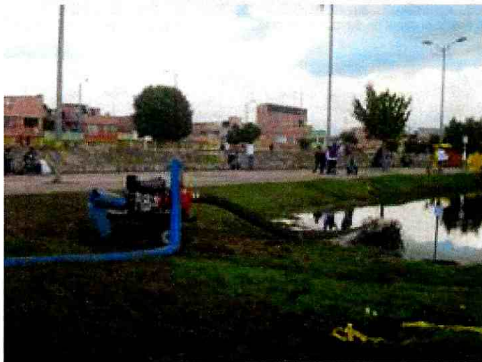
Foto 35. Bombeo localizado desde el conjunto residencial Alameda a un predio adyacente al Canal Cundinamarca
