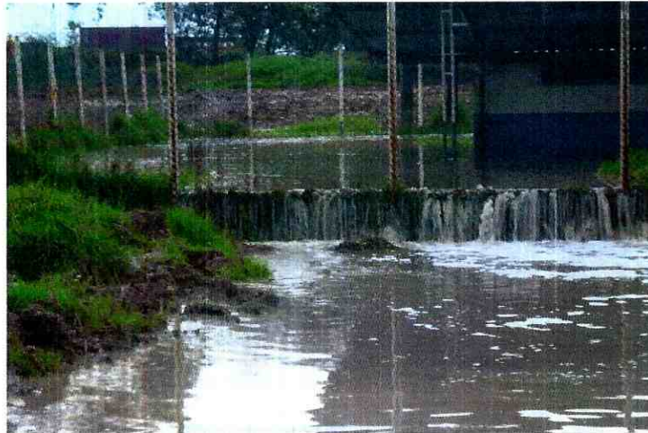
Foto 13. Estación elevadora Fontibón Inundada
