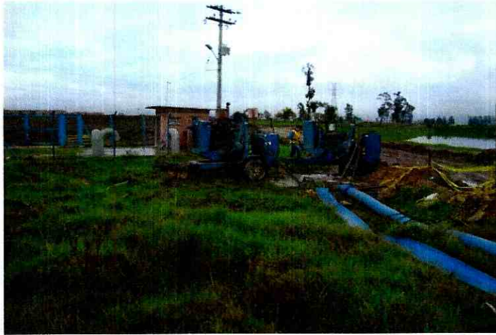
Foto 9. Bombas para evacuación de aguas del túnel hacia el Canal Cundinamarca.
