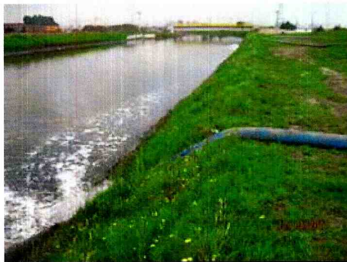
Foto 37. Descarga de las tres bombas instaladas en la estación elevadora Fontibón hacia el río Fucha
